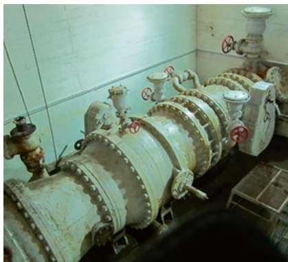
Bild 1: RKV DN 1 200 in Schieberkammer, rechter Grundablasses (Quelle: EDR)
